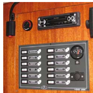
Het VDO schakelpaneel met accuvoltmeter
