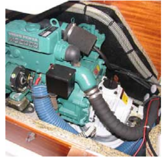
Motorruim; met afschuifbare geïsoleerde kap
